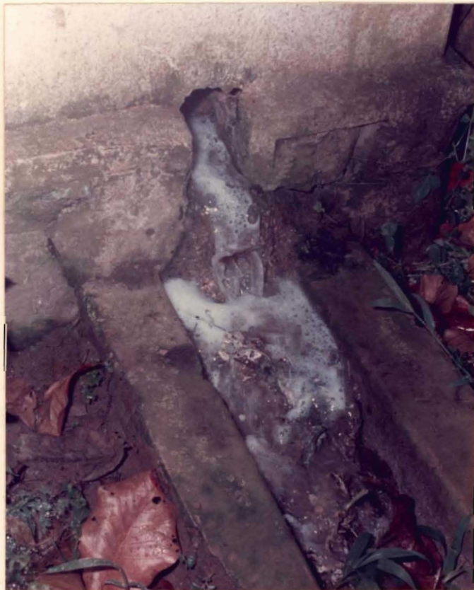
(b) Effluent discharge
